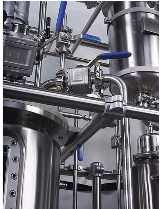
Grundgestell einer Rohranlage für technische Flüssigkeiten und Gase
